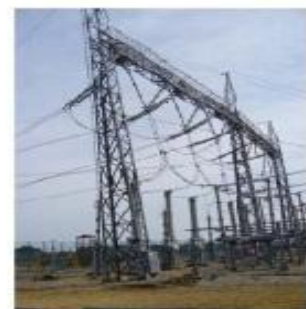
撮影：東京電力株式会社 H23.3.11
