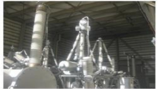
撮影：東京電力株式会社 H23.3.23
