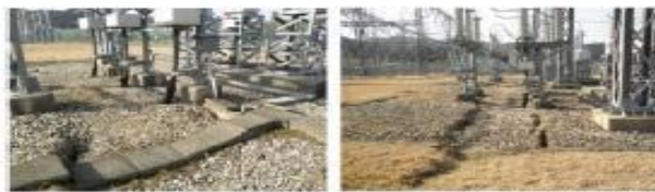
撮影：東京電力株式会社 H23.3.12
