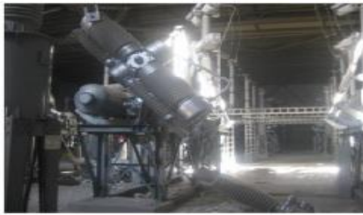
撮影：東京電力株式会社 H23.3.23
