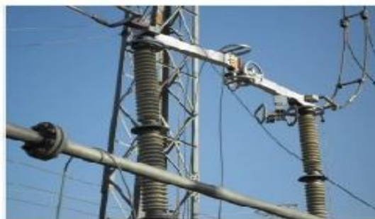
撮影：東京電力株式会社 H23.3.12
